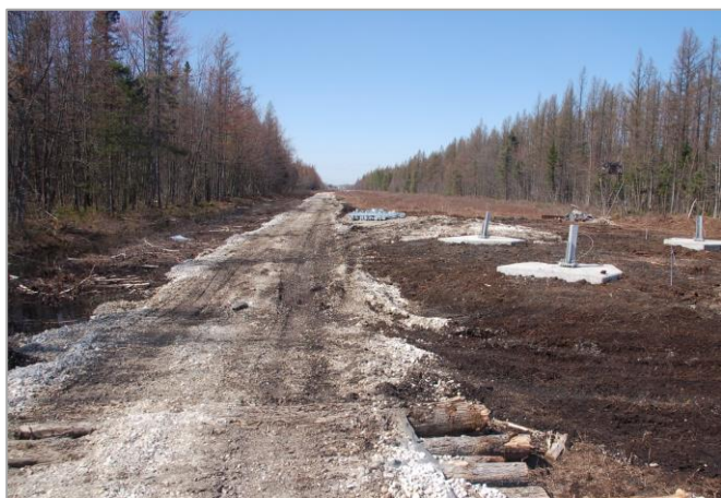
Site de Sainte-Eulalie, avant les travaux de réhabilitation à l'automne 2012 / Site of Sainte-Eulalie, before rehabilitation works in autumn 2012. Photo : L. Rochefort
